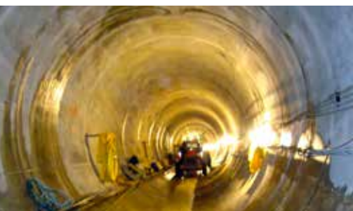
Hidroeléctrica Pirrís, Costa Rica.
